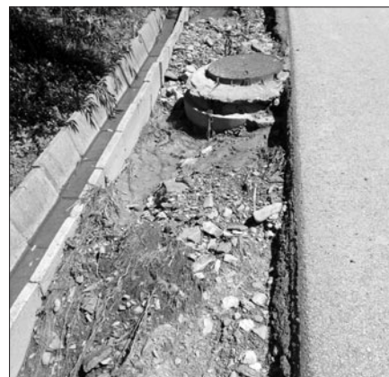
Uszkodzona kanalizacja w Kasince Małej
