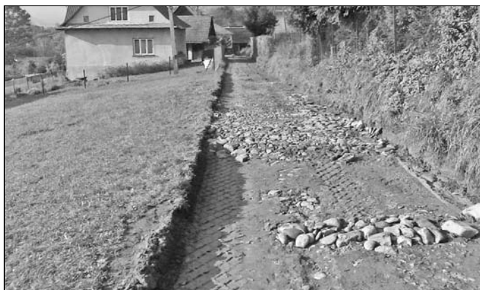
Droga do osiedla Polaki w Mszanie Górnej - przed modernizacją
