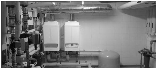
Zmodernizowana kotłownia w szkole w Olszówce
